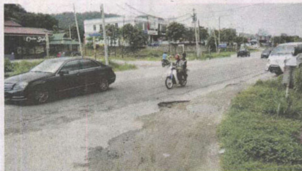
Keadaan jalan yang berlubang dan membahayakan nyawa pengguna jalan raya.
